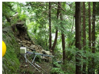
石積擁壁の崩落による観測機器の破損
